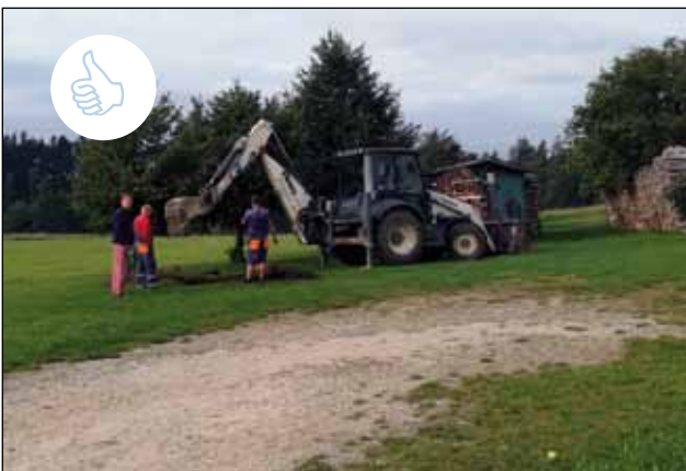
10. 9. ☺ Havárie na vodovodním řádu u č.p.17 v Jarošově nad Nežárkou.
